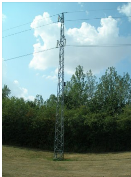
En af de eksisterende højspændingsmaster i området.
